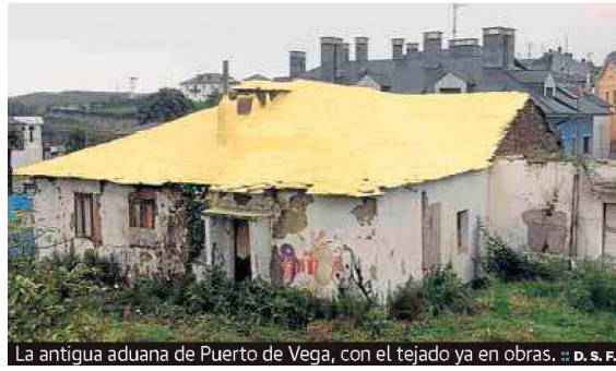
La antigua aduana de Puerto de Vega, con el tejado ya en obras. :: D. S. F.
