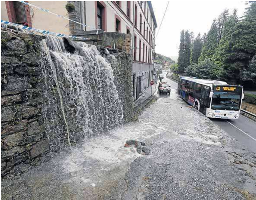
El muro de contención reventado de nuevo por la acumulación de agua en Trubia. :: PABLO LORENZANA
